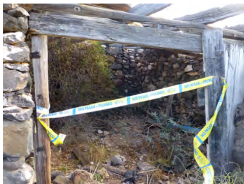
Conjunto de edificaciones rurales que fueron okupadas, quemadas y precintadas en El Lirón, Ingenio.
