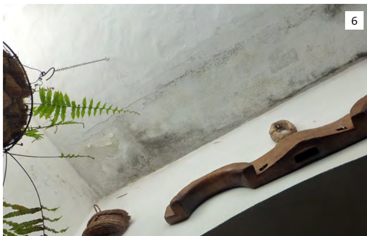
4. Desmantelamiento de horno; 5. Condensaciones por uso de materiales inadecuados y falta de ventilación; 6. Colonización de mohos y hongos.
