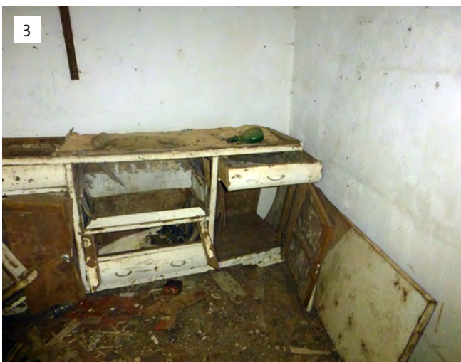
1-2. Pérdida de material por falta de mantenimiento y degradación natural de soporte; 3. Vandalismo.
