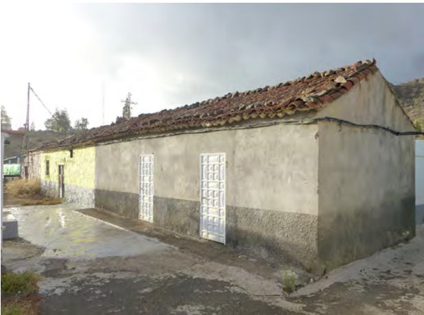
Rehabilitación en edificación tradicional rural. La cubierta se mantiene, pero se enfosca con mortero de cemento, se coloca una tirolesa en la parte inferior de la fachada y se sustituyen las carpinterías por puertas de aluminio, materiales no traspirables ni adecuados.
