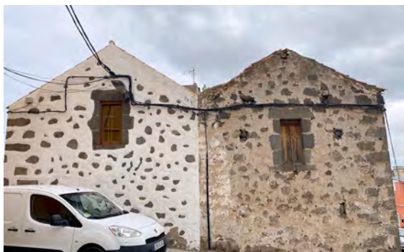
Ejemplo de rehabilitación de cubierta (a la izquierda de la imagen) donde no se respetan los valores de la cubierta: altura de la cumbre, proporciones y la curvatura del alero.
