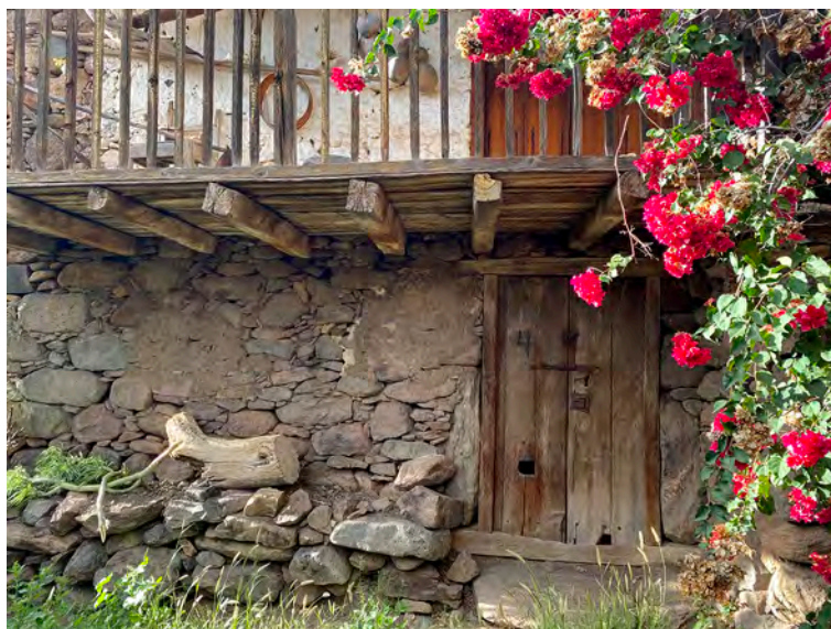
Restos de mortero de barro en fachada, enjalbegado en planta alta, invariante I de dos plantas, Veneguera, Mogán.
