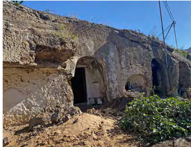
Afecciones en el roso: grietas por vegetación y poste de tendido eléctrico, disgregación por erosión y humedades por capilaridad.
