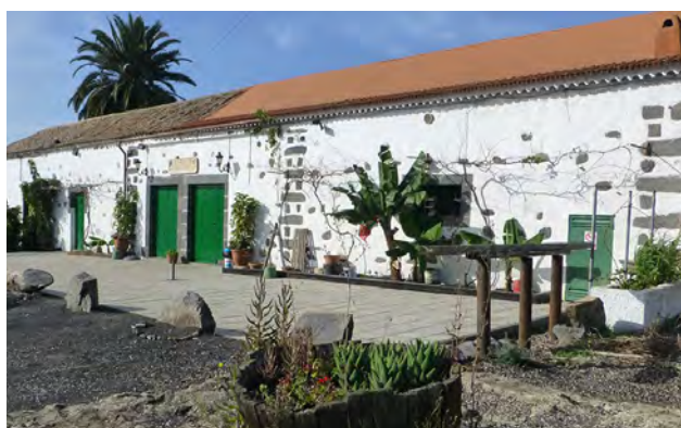
Cubierta a la que se le ha retirado la teja y se hace una torta de mortero de cemento y pintado con pintura plástica, material no transpirable ni adecuado
