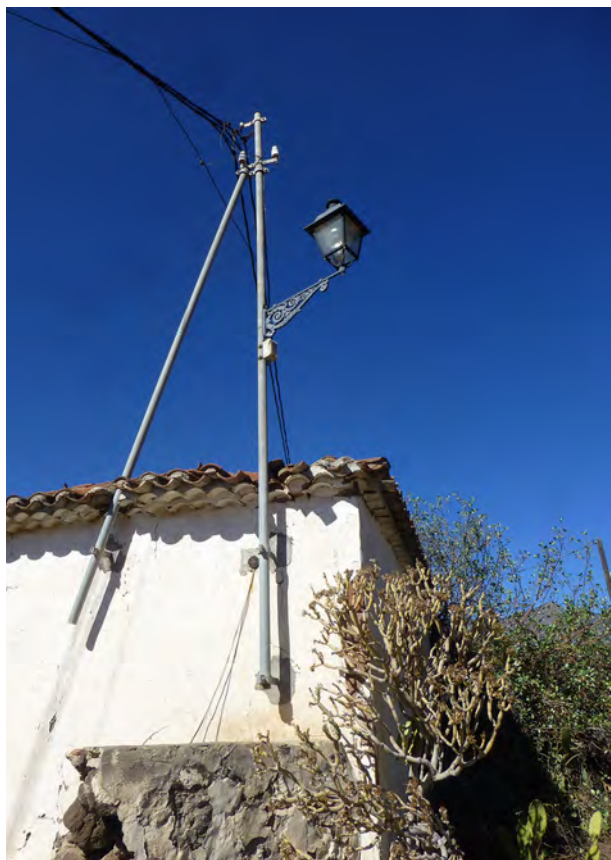
Vivienda con alero roto para colocación de postes. Se deberá solicitar su retirada. Las Lagunas, Santa Lucía de Tirajana.
